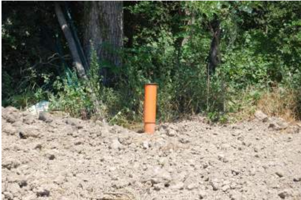
Foto n°5: Uno dei piezometri installato nella cava Crocetta 4
