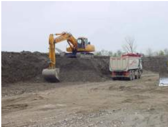
Foto n°4: La tipica modalità di scavo applicata nelle cave lungo l'asta del F. Trebbia
