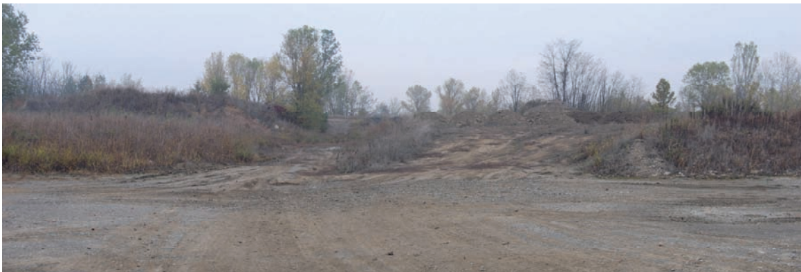
Foto n°5: Particolare dell'area di piazzale con cumuli di terreno agrario in attesa di essere ridistesi sulle aree di scavo
